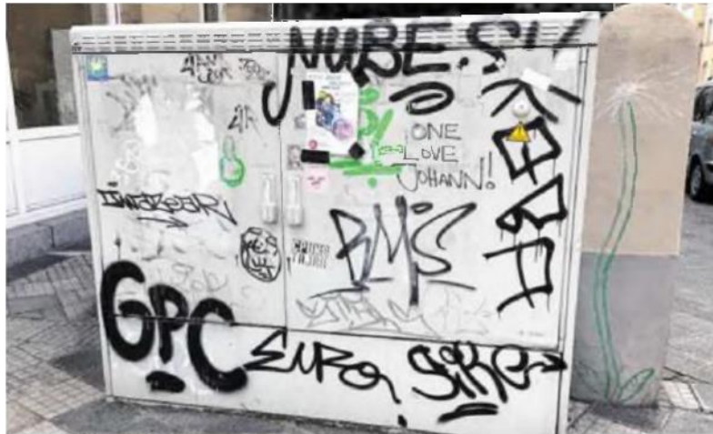
Beschmiert und grau: der Strom- und Verteilerkasten vor seiner Umgestaltung durch das Projekt Farbe im Quadrat.
